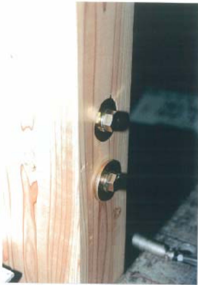
写真-3 破壊状況
