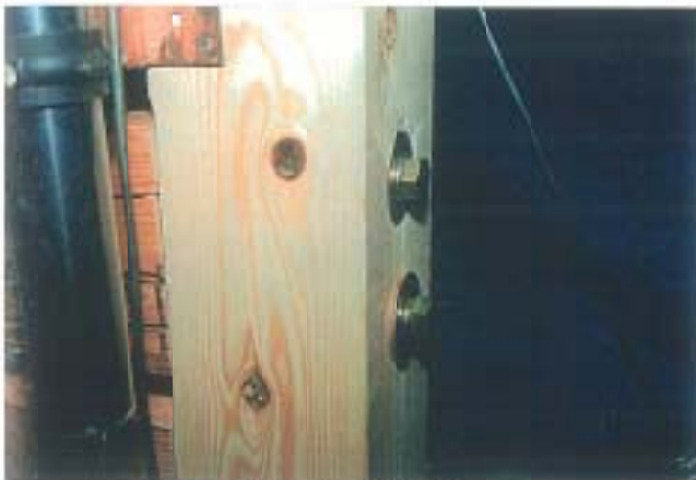
写真-3 破壊状況
