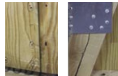
●面材耐力壁の損傷 ●筋かいの損傷
